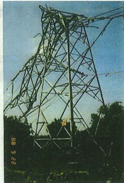
地震動による66kV鉄塔の折れ曲がり (1999年台湾集集地震)
