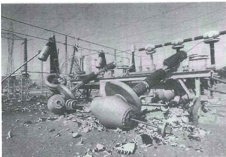
トップヘビー型空気遮断器の倒壊 (1989年ロマ・プリエータ地震)
